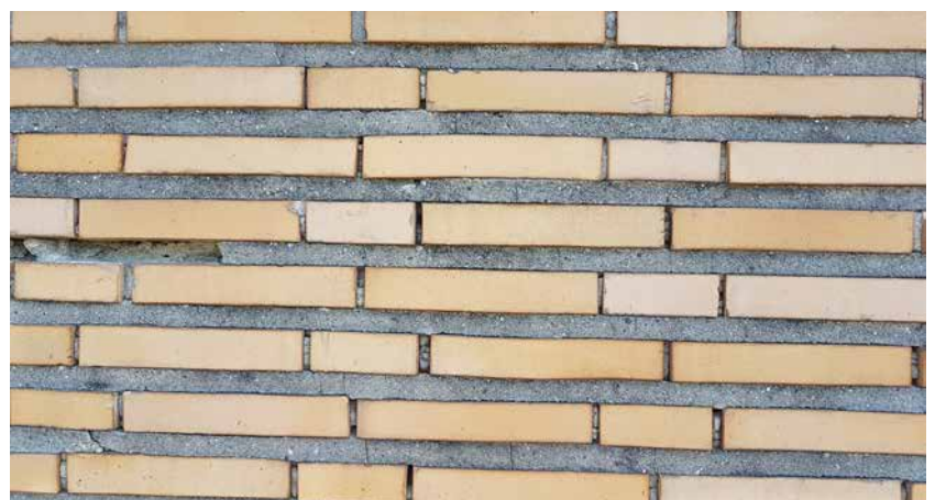
Het originele parement werd hervoeegd met een cementrijke mortel (foto Patine)
